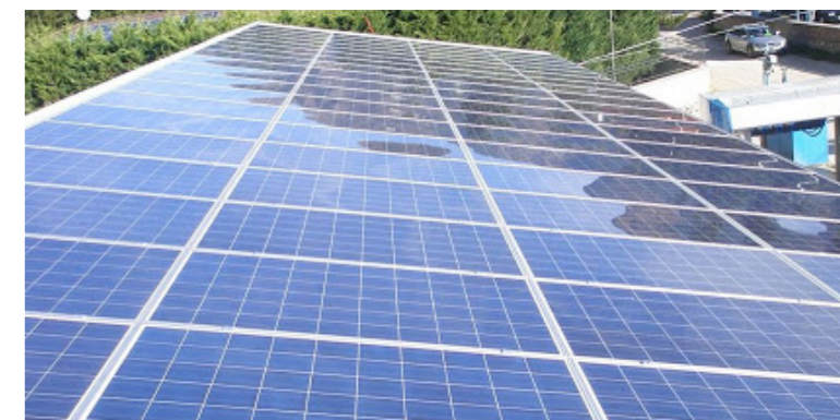
Pannelli fotovoltaici sulle coperture
