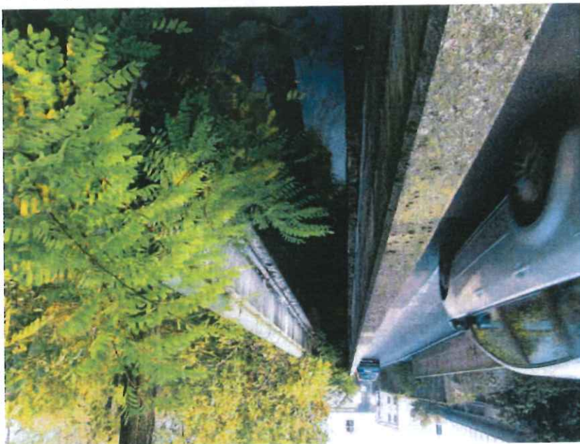
Vista dalla sponda idrografica sinistra della trave in cemento a supporto della tubazione presente a monte dell'attraversamento di Viale Lazio/Via Cima.
