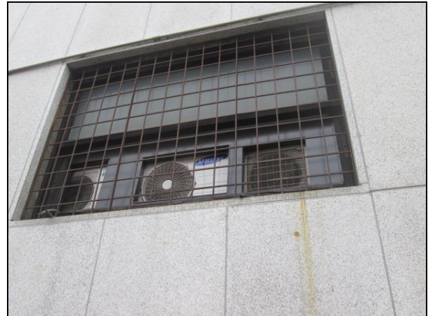
Unità esterne presso facciata sud
