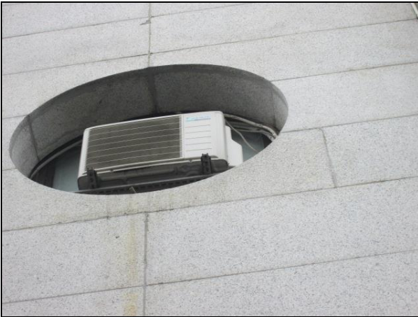
Unità esterna presso facciata sud
