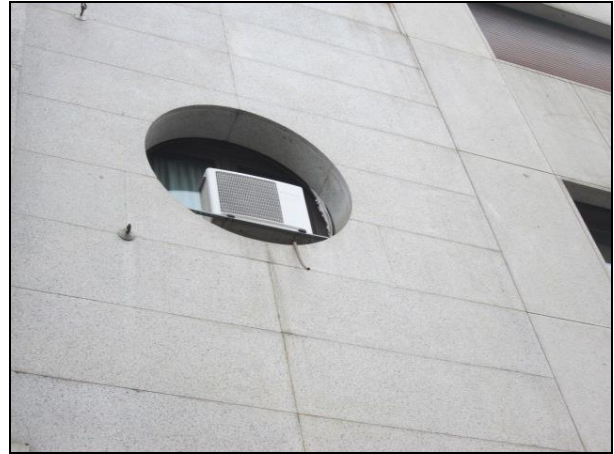
Unità esterna presso facciata sud
